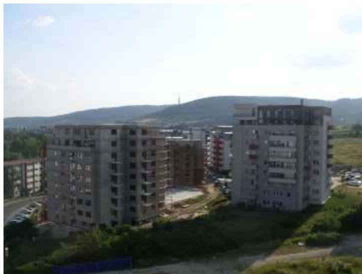
Obr.č.4 Výstavba obytných domov bez koncepčného návrhu územia (Rača- Rinzle). (foto: autor)
