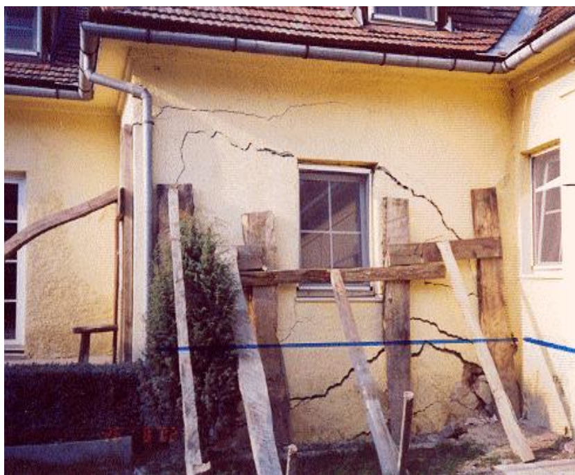
Obr. 6 Porušená časť rekonštruovaného domu v Devíne počas povodne v roku 2002 (foto Hulla).
