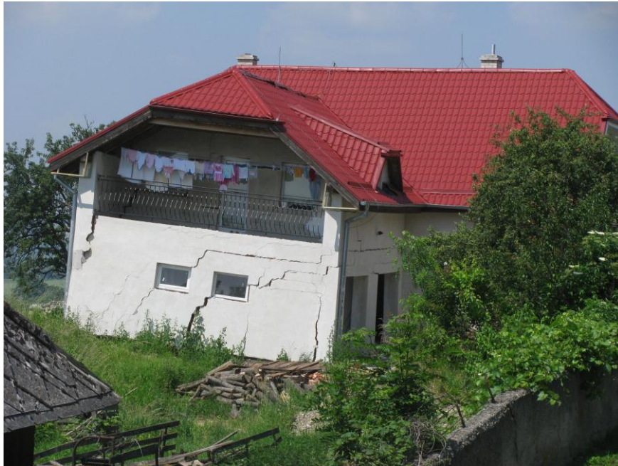
Obr. 11 Porušený rodinný dom na zosuvnom svahu v Nižnej Myšli v roku 2010 (foto Kopecký).
