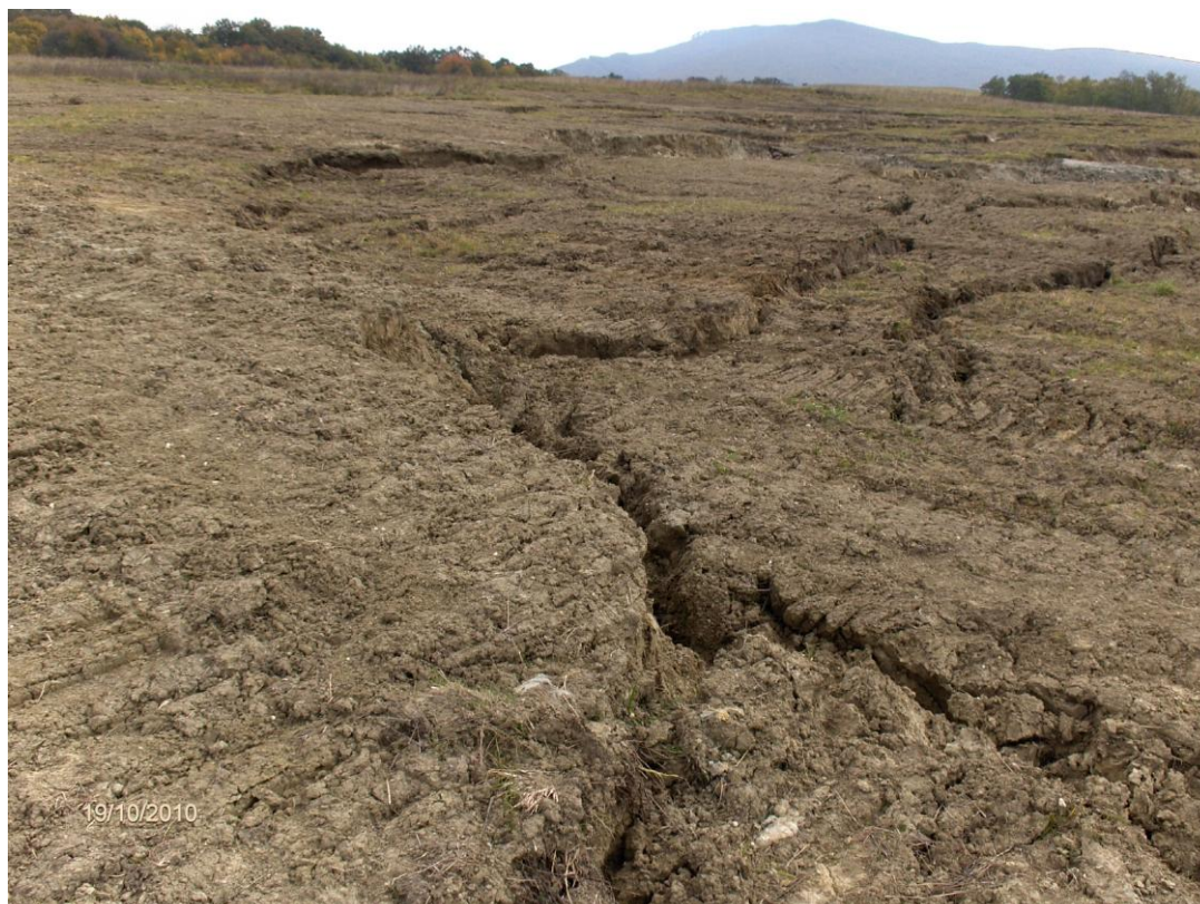
Obr. 10 Poruchy povrchu zosuvného územia pri Nižnej Hutke, kde bola porušená cestná komunikácia (foto Hulla).
