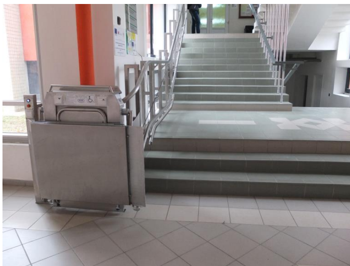
Obr. 10. Schodisková plošina na schodisku v pavilóne A
