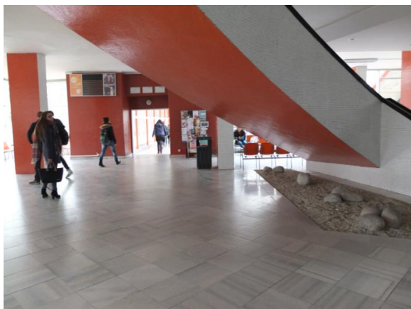
Obr. 20. Nedostatočne označený (v úrovni podlahy) podschodiskový priestor na SPU v Nitre
