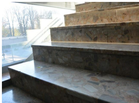
Obr. 21. Nevyhovujúci tvar stupňa na schodisku na Ekonomickej fakulte SPU v Nitre
