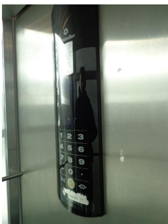
Obr. 5. Nevyhovujúce dotykové ovládanie vo výťahu na Technickej fakulte SPU v Nitre
