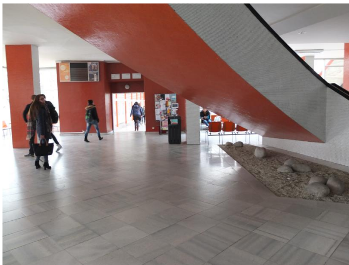
Obr. 8. Nedostatočne označený podschodiskový priestor
