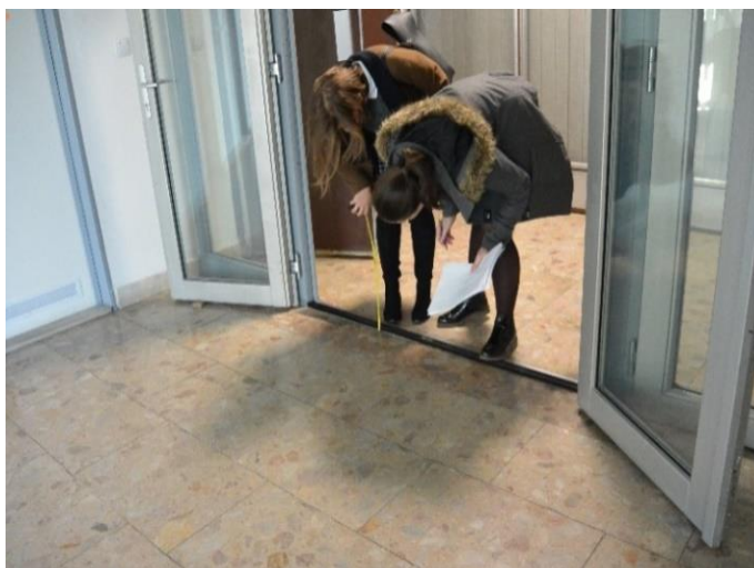
Obr. 9. Vstup do dekanátnych priestorov; nevhodná výška prahu na Ekonomickej fakulte SPU v Nitre
