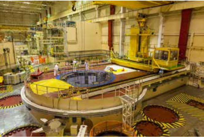
↑ Jadrové elektrárne zabezpečujú stabilnú výrobu elektriny počas celého roka.
