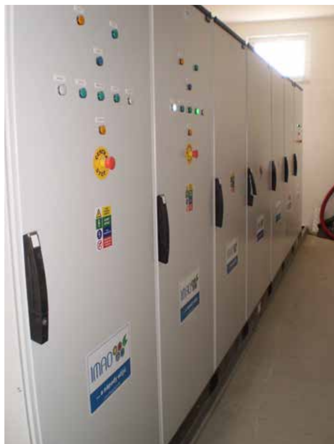
Rozvodňa nn TS 7800 pred a po modernizácii
