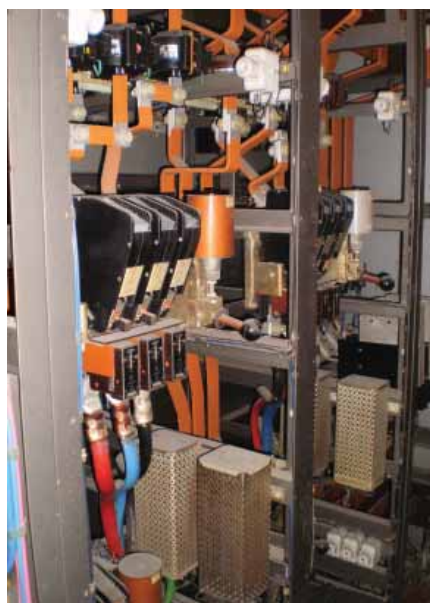
Stará transformátorová stanica TS 734 nn rozvádzač.
