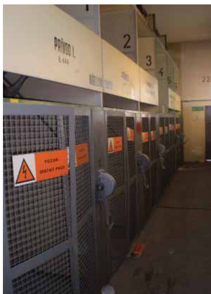
Stará transformátorová stanica TS 734 kobkový vn rozvádzač.
