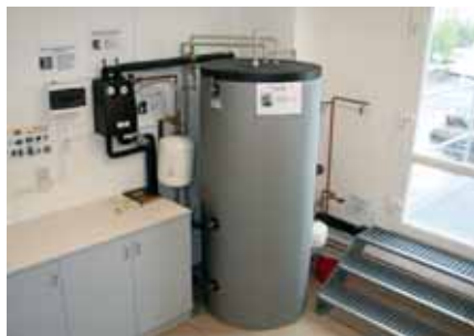
Časť tepelného solárneho zariadenia.
