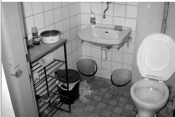
Toalety na internáte pred rekonštrukciou
